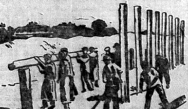
Постройка нового овощного хранилища в колхозе на 1 мая (Городищенский район, Мещеряковский колхоз).
