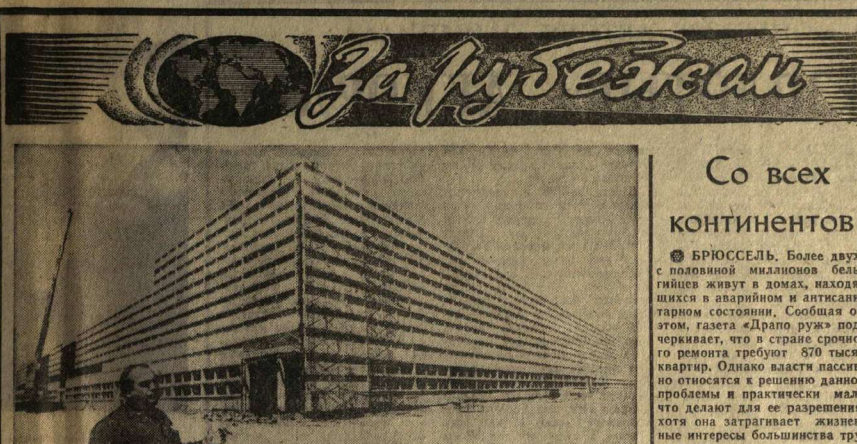
Куба. В пригороде города Ольгиня сооружается при содействии Советского Союза завод по производству бортовых комбайнов «КТИ». На снимке: строительство главного корпуса завода. На первом плане — начальник строительства завода Хосе Рамон Лима. (Фотохроника ТАСС.)
