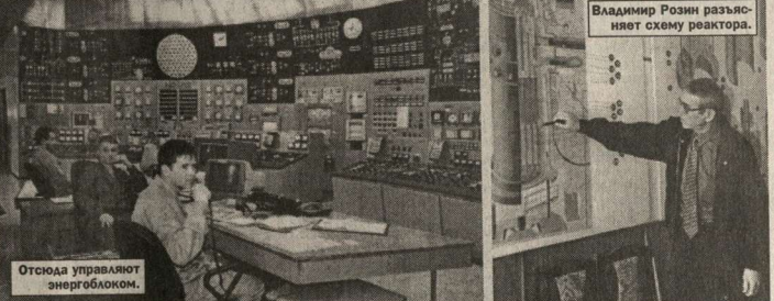
Отсюда управляют энергоблоком.
