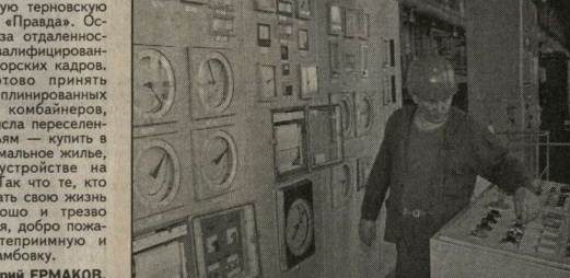
Турбинный зал ТЭЦ
