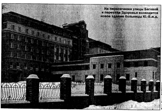
На пересечении улицы Боговой и переулка Здоровья возводится новое здание больницы Ю.-В.ж.д.
