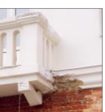
■ Балкон дома на улице Ленина отстранирован и уже разрушается из-за недоработок жестянщика.
