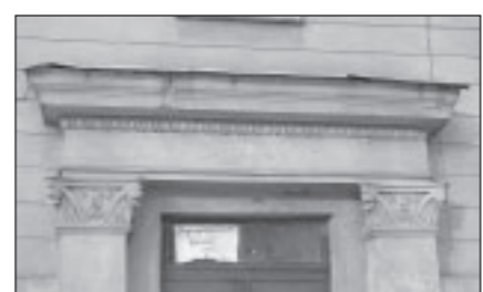
Центр Воронежа. Даже примитивный козырек-жестянка сколько десятилетий спасает карниз над подъездом.
