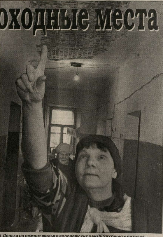
Деньги на ремонт жилья в воронежских райДЕЗах берут с потолка.
