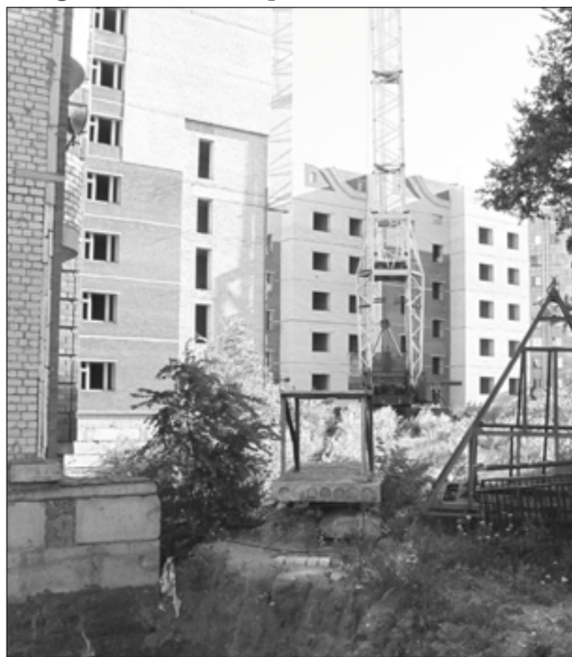
На брошенной стройплощадке царствует буйная растительность.
