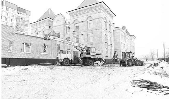
Александр Гусев: «Выдерживая темпы строительства детских садов, нельзя забывать и о качестве работ».
