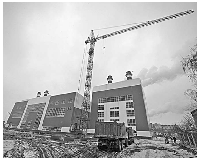
Возведение нового энергоблока ведётся в отдельном стоящем корпусе по схеме двух дубль-блоков.
