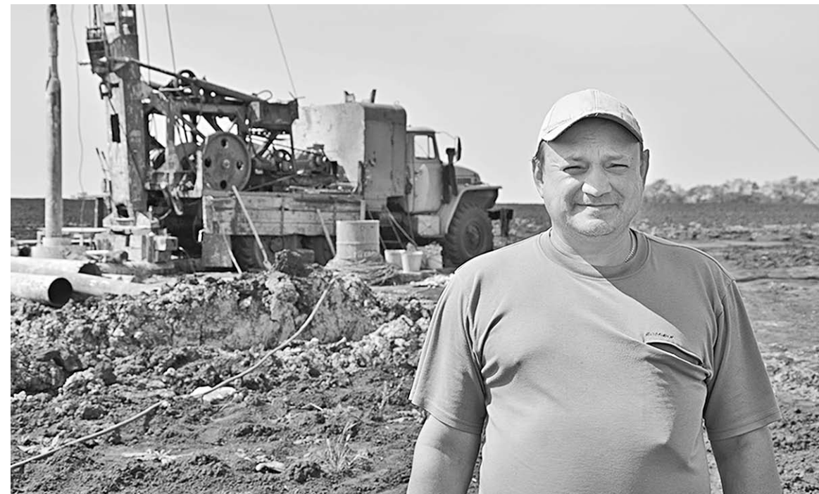
Важный объект любой стройки – источник водоснабжения. Начальник строительного участка Андрей Хруц рассказал, что уже пробурили более двухсот метров до водоносных слоёв.
